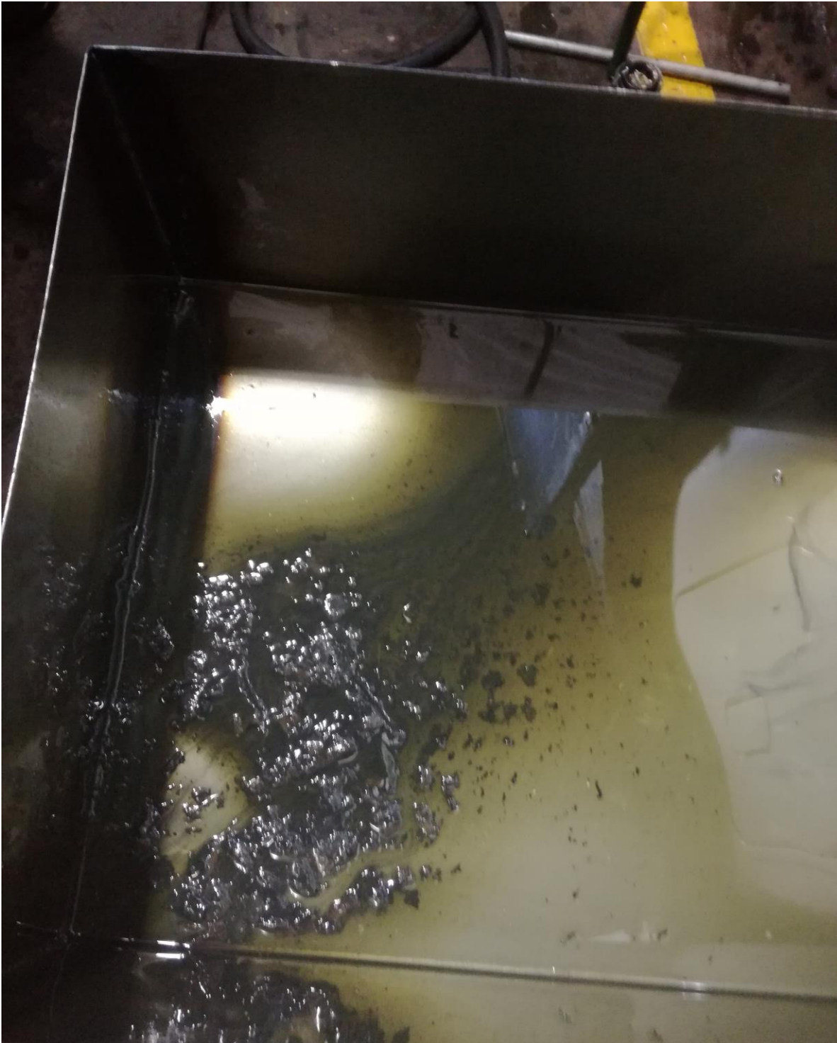
Residuos encontrados en tanque de aceite Hidráulico.
