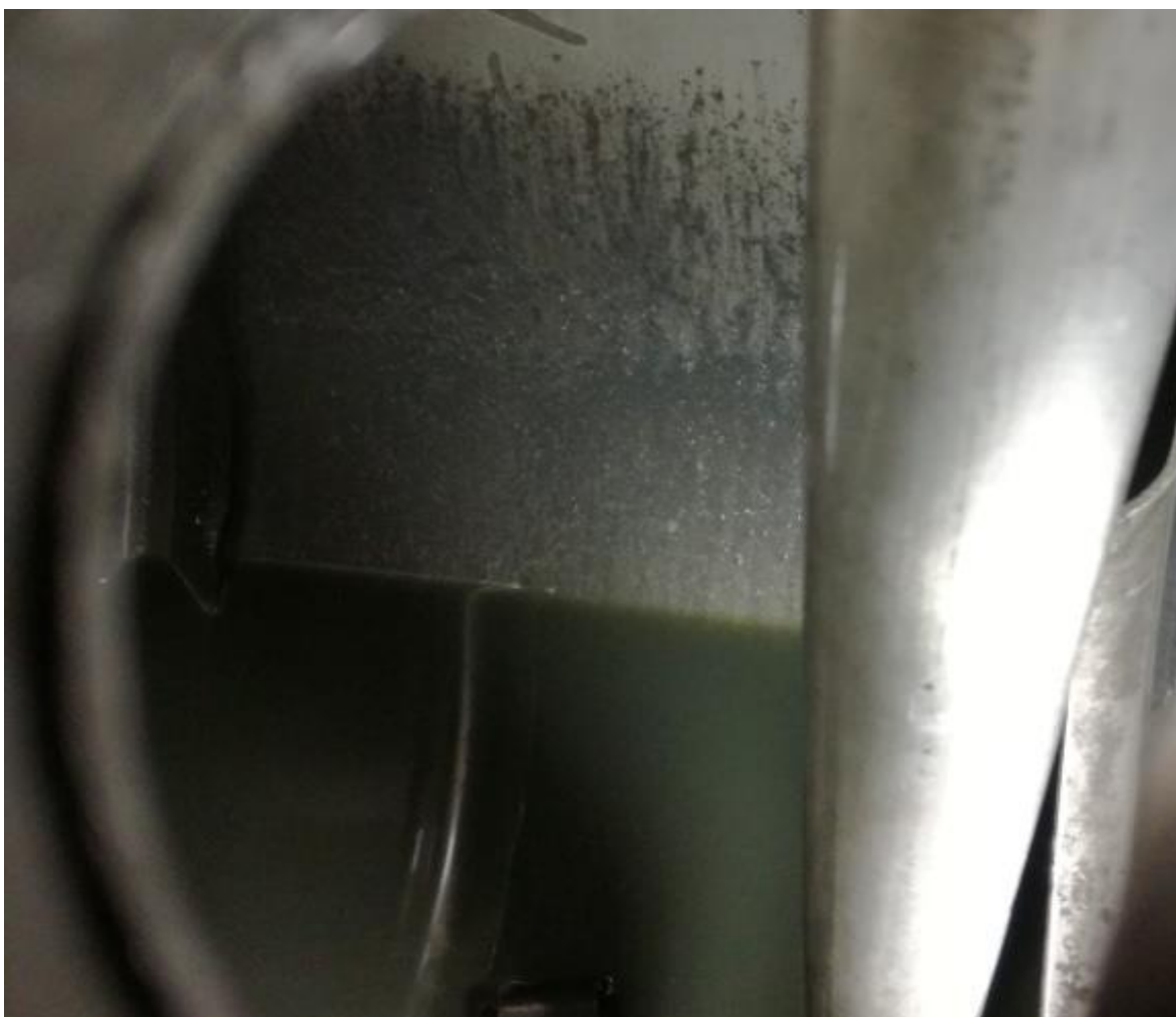
Tanque de aceite hidráulico antes del mantenimiento.
